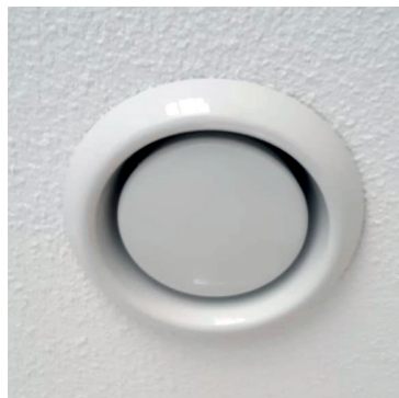
Ventiel mechanische ventilatie
